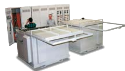
Instalacja pieca solnego do wyżarzania elementów aluminiowych dla przemysłu lotniczego
