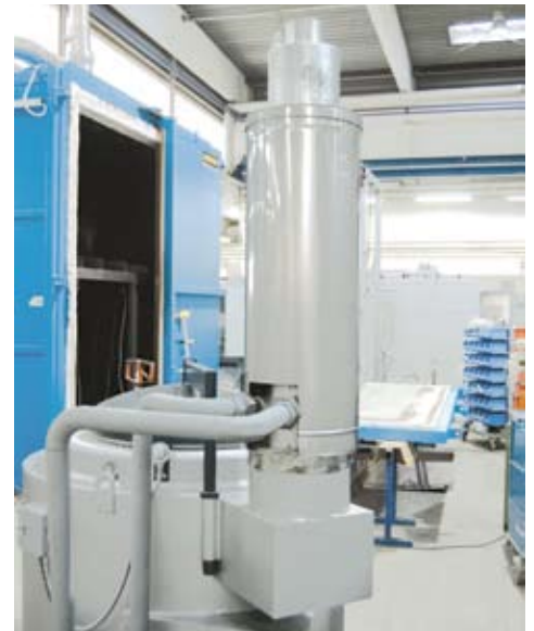
Wymiennik ciepła w kanale gazów odlotowych
