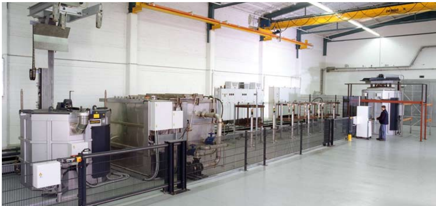
Całkowicie automatyczna instalacja do ulepszania ciepłego aluminium z 2 piecami szybowymi, wanną wodną i 6 stanowiskami postojowymi
