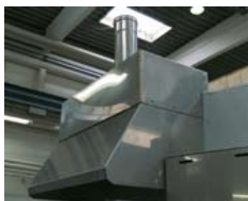
Odciąg gazów odlotowych nad otworem załadoczym
