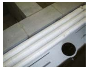
Specjalne cegły w komorze pieca, wielowarstwowa izolacja
