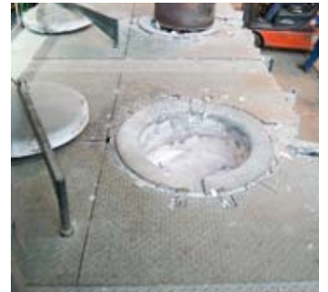
Platforma załadunkowa na piecu K 360/12
