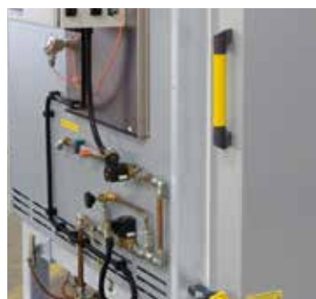
Układ zasilania gazem i termoelement przy piecu
